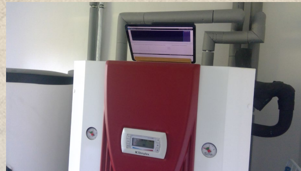
Wärmepumpen-Überwachung im Haustechnikraum
